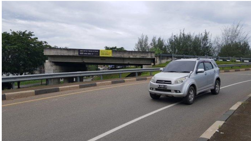
Jembatan Pango, Banda Aceh terlihat masih menggantung alias putus yang dipersiapkan untuk pembangunan lanjutan menghubungkan ke Jalan Soekarno Hatta, Aceh Besar.
