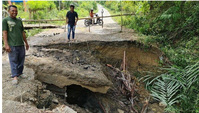
Warga Mukim Langgien, Kecamatan Bandar Baru, Pidie Jaya memperhatikan kondisi ruas jalan utama tujuh gampong yang telah ambruk di Gampong Baroh Cot, Langgien, Selasa (2/2/2021)
